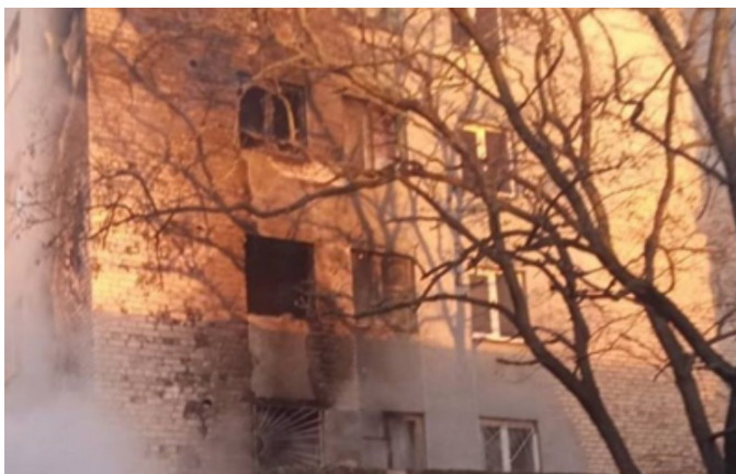
Ein durch Raketenbeschuss beschädigtes Universitätsgebäude der Staatlichen Universität Cherson. © Presseportal der Staatlichen Universität Cherson: https://www.kspu.edu/PublisherReader.aspx?newsId=16317 .
